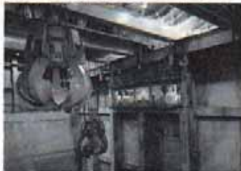
豊野環境衛生センター ゴミクレーン
